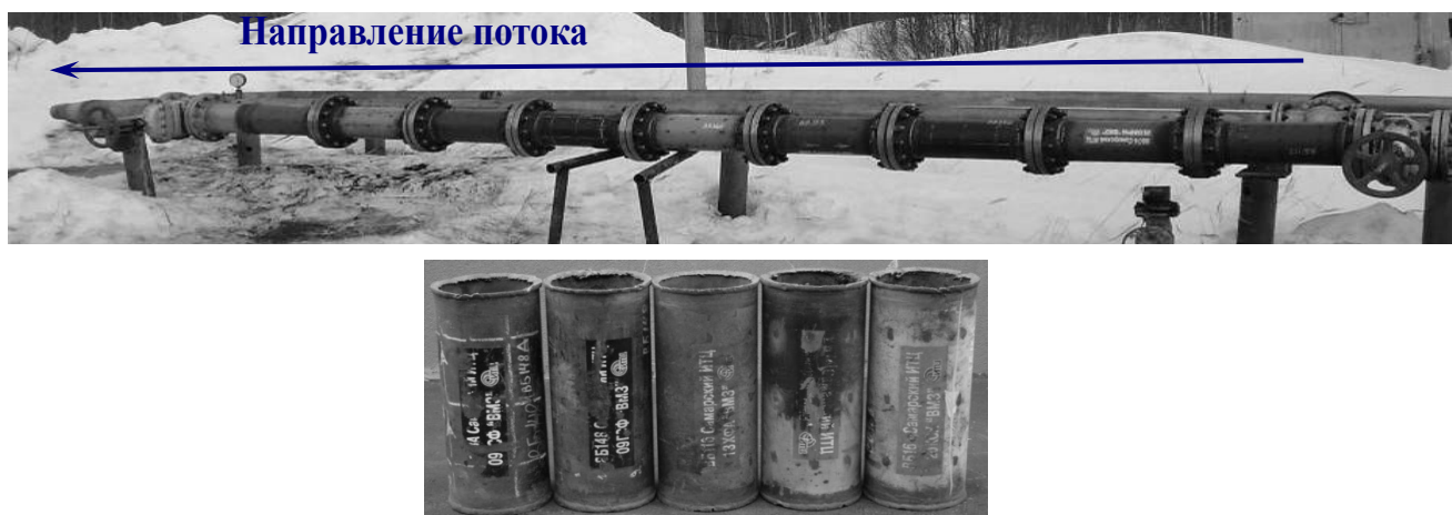
Рис. 1. Байпасная линия испытания труб на нефтесборном коллекторе к. 34А Мамонтовского месторождения ООО «РН-Юганскнефтегаз» и катушки, вырезанные из труб Fig. 1. Bypass piping to test pipes on the oil gathering main k.34A of Mamontovskoye oilfield of LLC RN-Yuganskneftegaz and the spools cut from the pipes
