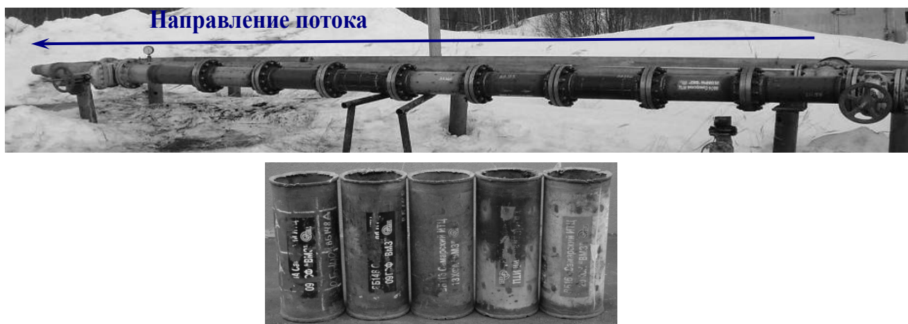
Рис. 1. Байпасная линия испытания труб на нефтесборном коллекторе к. 34А Мамонтовского месторождения ООО «РН-Юганскнефтегаз» и катушки, вырезанные из труб Fig. 1. Bypass piping to test pipes on the oil gathering main k.34A of Mamontovskoye oilfield of LLC RN-Yuganskneftegaz and the spools cut from the pipes
